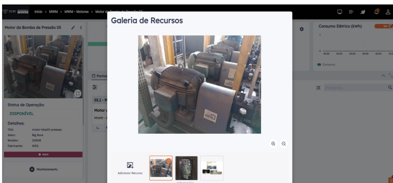
Gestão completa do equipamento
