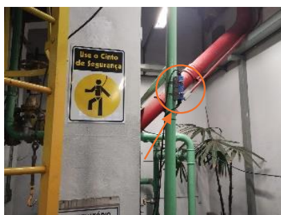
Figura: Medidor ultrassônico instalado
