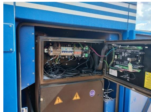
Figura: Conexão do multimetror ao Controlador DSE 8610
