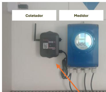
Figura: Instalação do Connect 2.0 com medidor Magnético
