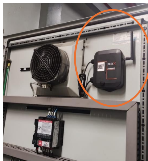
Figura: Instalação do Connect 2.0 na parte interna do painel
