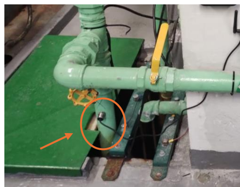
Figura: posicionamento do medidor de pressão
